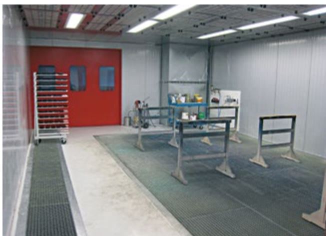
Abb. 1 Lackiererraum mit eigenem Ablüftungsbereich
